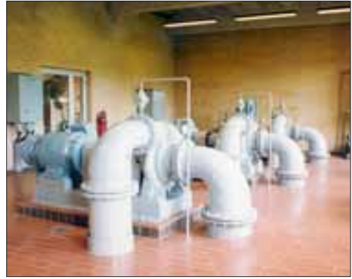
Pumpesalen med de 3 pumper, der sørger for indpumpningen til Roskilde.
