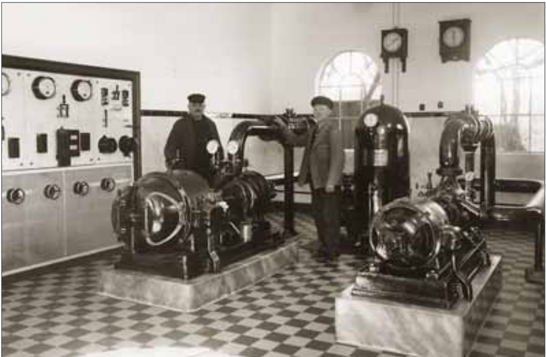
Foto fra maskinsalen på Hellig Kors Vej med de 2 eldrevne pumper. Ca. år 1930. Foto: Fotografisk Atelier, A. Christiansen.
