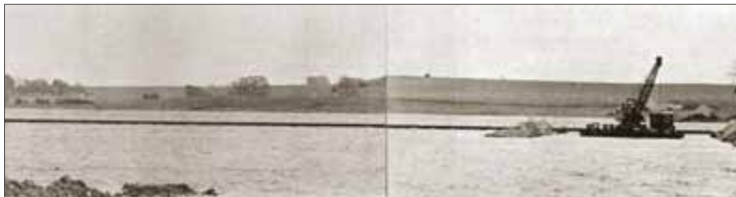
Plastledningen flyder på vandet, inden den sænkes ned på bunden af Lejre Vig. Foto fra Roskilde Tidende 26.05.72
