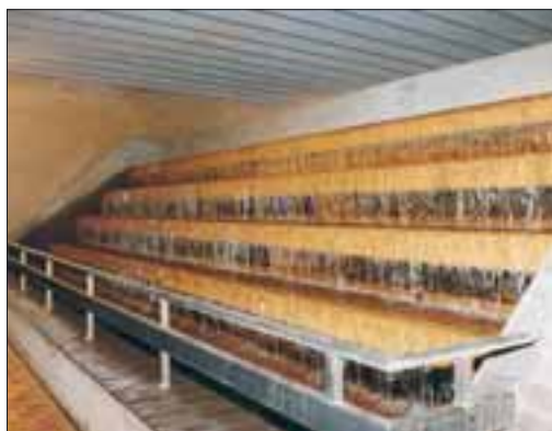
En del af iltningstrappen, hvor råvandet afluftes og iltes.
