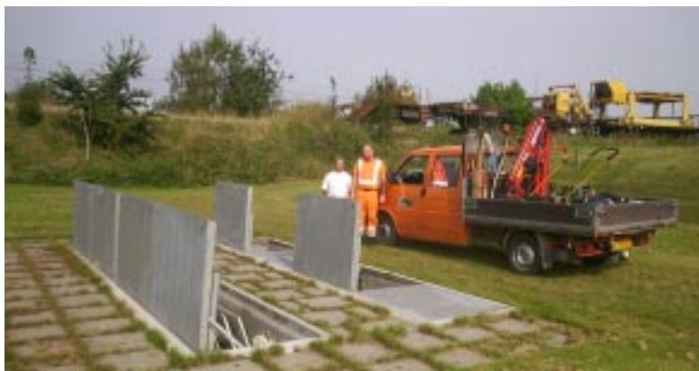
Roskilde Kloakforsyning ved overløbsbygværk OC20
