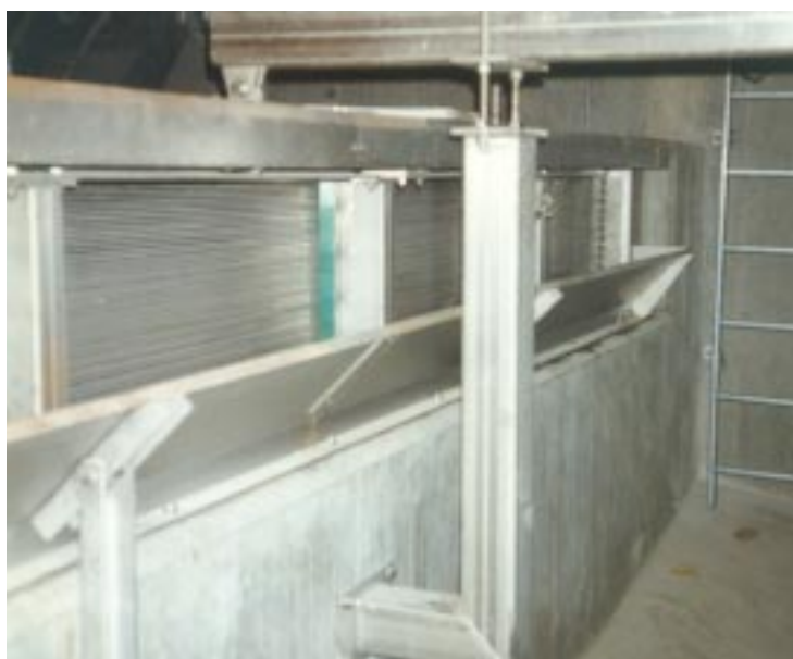
Mekanisk rist ved overløbsbygningsværk OC16 ved Sankt Ibs Vej
